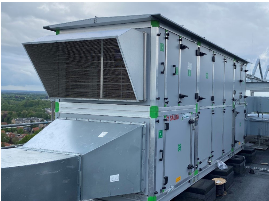
Figuur 8: luchtbehandelingskast in buitenopstelling
